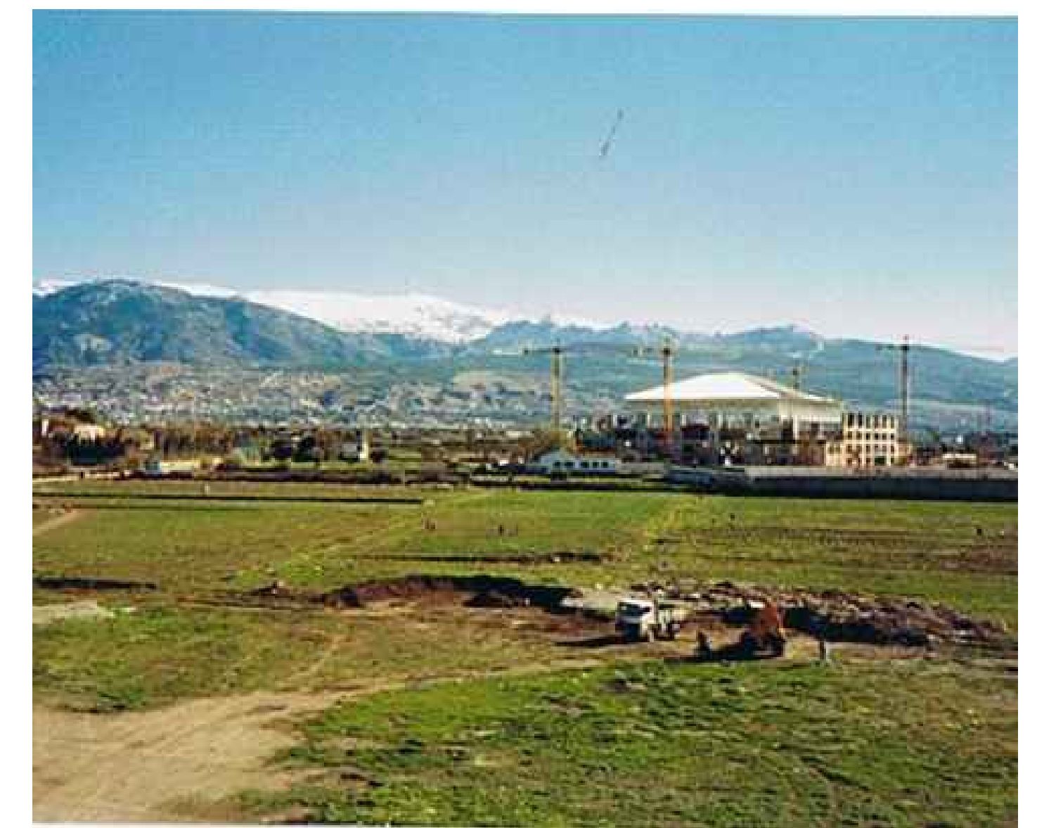
Fotografía de la ejecución de la estructura de la cubierta del palacio de deportes
