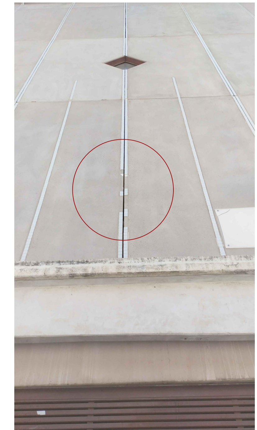
Ejemplo de reparaciones en el gresite a realizar
