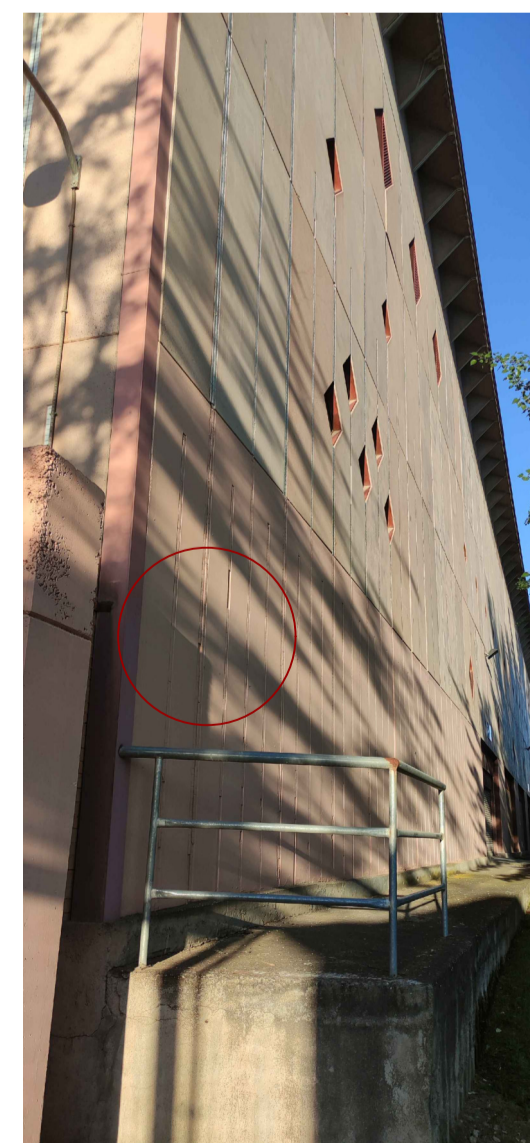
Ejemplo de reparaciones en las placas de hormigón prefabricado y gresite a realizar
