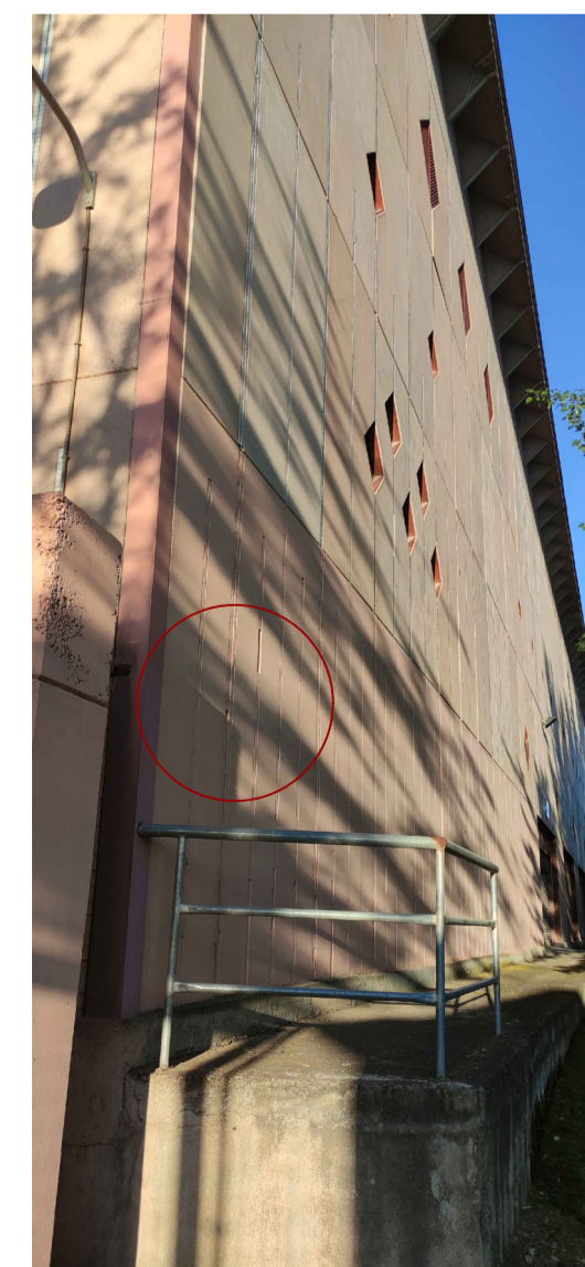
Ejemplo de reparaciones en las placas de hormigón prefabricado y gresite a realizar
