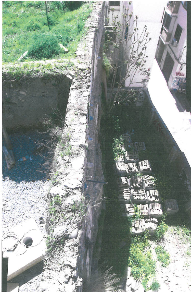
Fotografía 1: Estado actual de la muralla y de la tapia de coronación. Vista cenital-oblicua. Observese la ondulación de la tapia.
